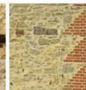
Chaîne d'angle en briques en terre cuite et joints de mortier de chaux
