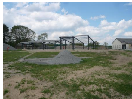
Sud N145 : bâtiment artisanal en construction face à la voie, entre la cristallerie et une ancienne habitation
