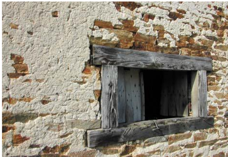
Enduit à la chaux sur façade « en lit » de paragneiss et encadrement en bois de châtaignier
