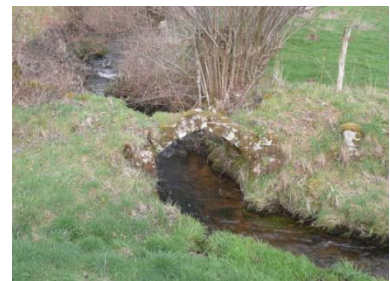
La Grange. Pont gallo-romain d'une seule voute, sur le ruisseau du Mas du Theil
