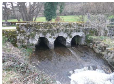
Chantemille. Pont sur le ruisseau de Félinas, composé de trois voutes en pierre de taille
