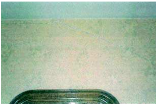
Fissuration intérieure, tapisserie déchirée - Maison André.
