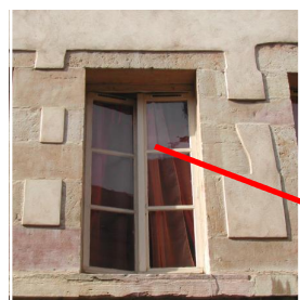
Surépaisseur et irrégularité des encadrements ou chaînages
