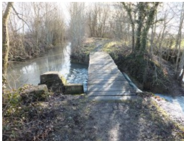
Illustration 10: Décharge de la Cent-Fonts par le seuil en amont du pont des Arvaux
