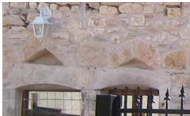
(Vue de deux arcs de décharge)
