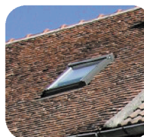
Châssis de toit
