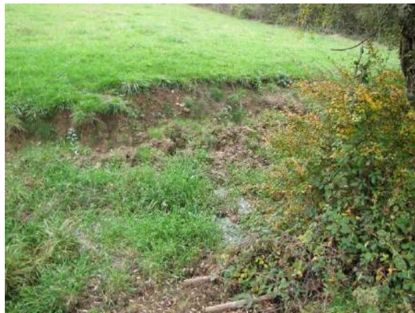
Erosion des berges par le bétail le long du ruisseau de la Combe de Mandelot
