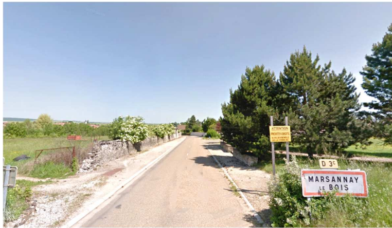
Vue depuis la route de Dijon. Malgré son état dégradé, le mur est un élément remarquable de ce paysage d'entrée de ville.
