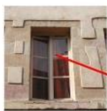
Surépaisseur et irrégularité des encadrements ou chaînages
