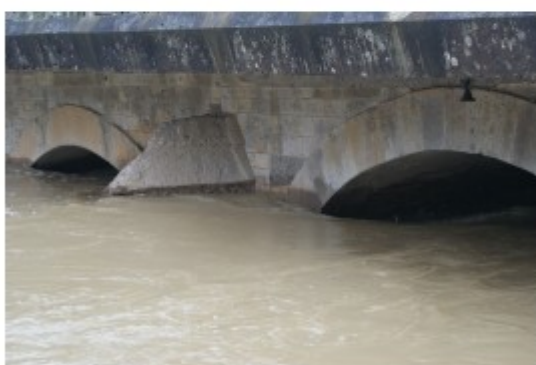
Station Limni DREAL : marque d'eau sur la pile du milieu
