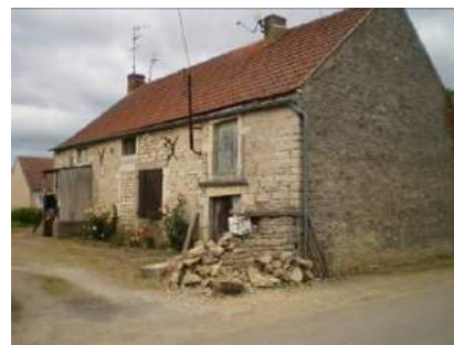
Eléments de clôture dégradés jouxtant l'espace public
