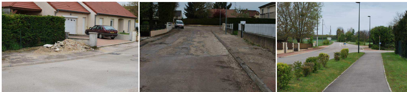
Impasse Claude Monnet – Un enrobé abimé Impasse des Carres – Cheminement doux le long de la RD 3.
