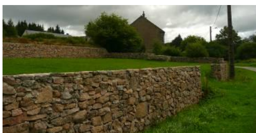
Exemple de muret en pierre situé à proximité de la mairie et à conserver
