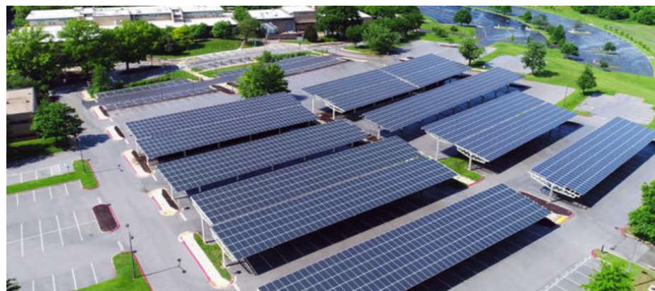
Exemple d'ombrières photovoltaïques déployées sur une aire de stationnement
