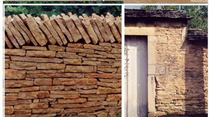
Sans enduit ou sous un mauvais enduit, la pierre peut souffrir et se désagréger
