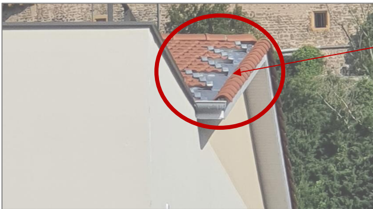
Type de « finition » de toiture interdite »
