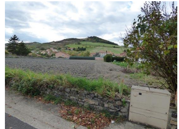
Mur en pierre existant le long de la Rue de la Dinette sur le secteur n°3
