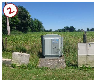
Localisation du transformateur électrique au sud-ouest
