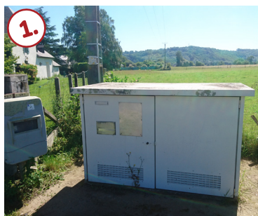
Transformateur électrique au nord-ouest du site
