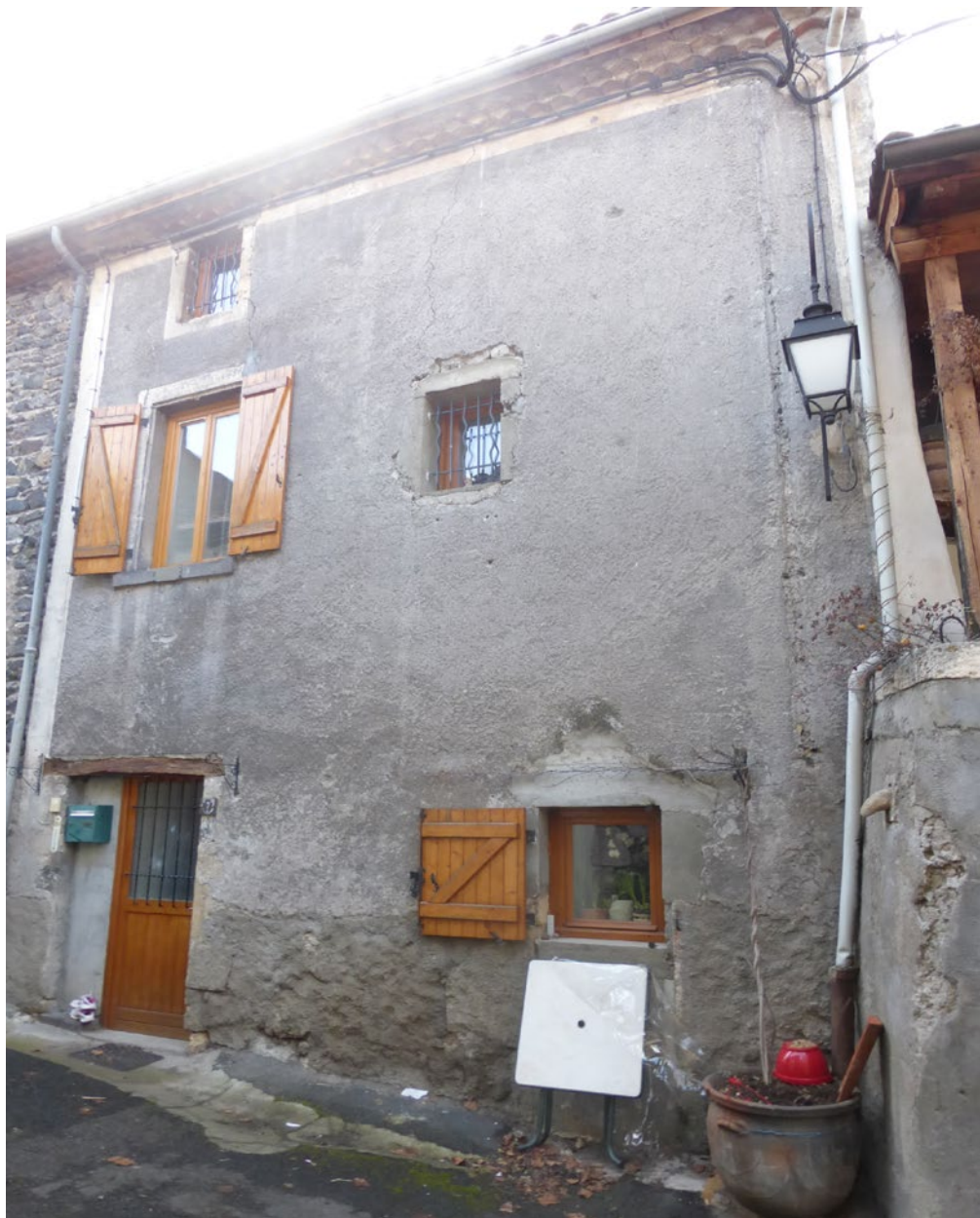
Les enduits ciments conduisent à la dégradation prématurée des maçonneries, qui demeurent cachées par l'enduit, qui s'altère peu. Les volets en «Z» sont des produits n'ayant pas leur place à Saint-Saturnin.
