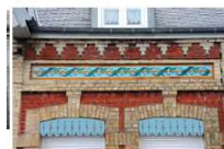
Montage photo : des lambrequins (en métal ou en bois) masquent les coffres de volets roulants = moyen efficace, simple à mettre en œuvre, et peu onéreux pour remettre en valeur une façade qui possède des coffres de volets roulants apparents.
