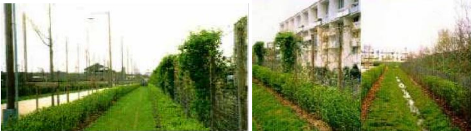
Exemples de fossés et de noues en limite séparative, « permettant ainsi de réconcilier des utilisateurs du parc d'activités avec la présence et la vue d'une eau vivante » (Source des photos : Paysage régulation et gestion des eaux pluviales – Direction de la Nature et des paysages, Sous-Direction des Sites et Paysages, Bureau des Paysages - Ministère de l'écologie et du développement durable )
