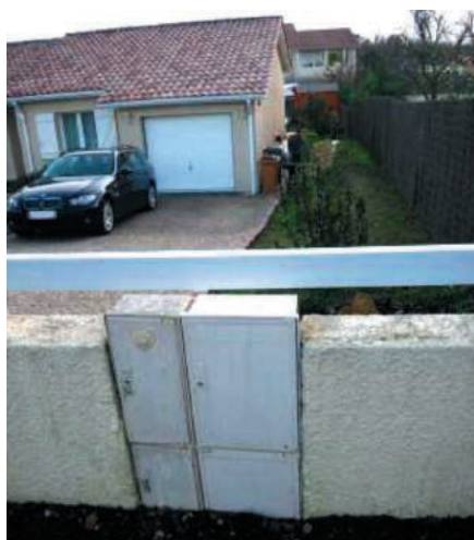
Figure 16 Situation classique d'une maison construite en contrebas du compteur électrique de la route d'accès (Source Socabat)
