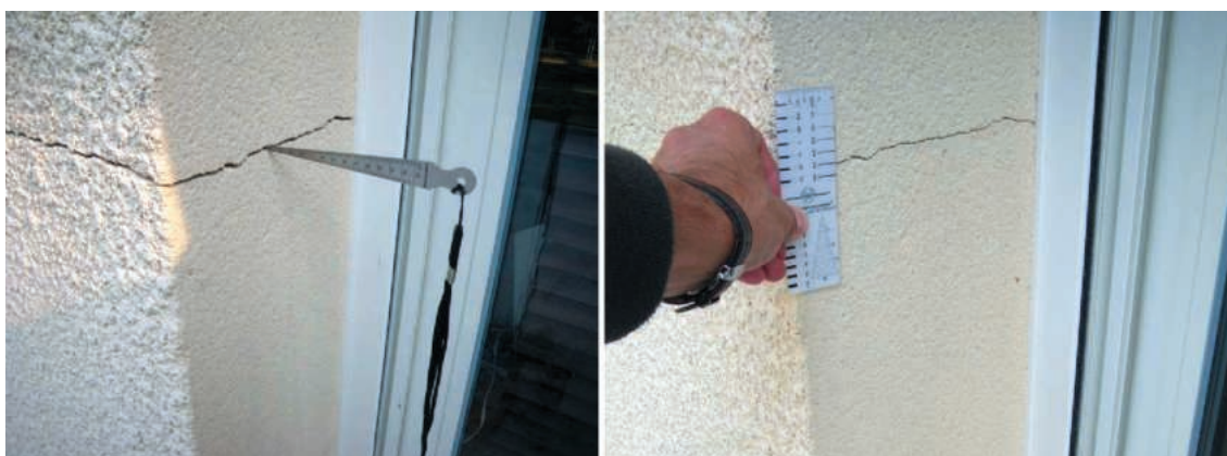
Figure 2 Exemple de la même fissure ouverte de 2 mm en fin d'été et de 0,5 mm en fin d'hiver (Source Socabat)
