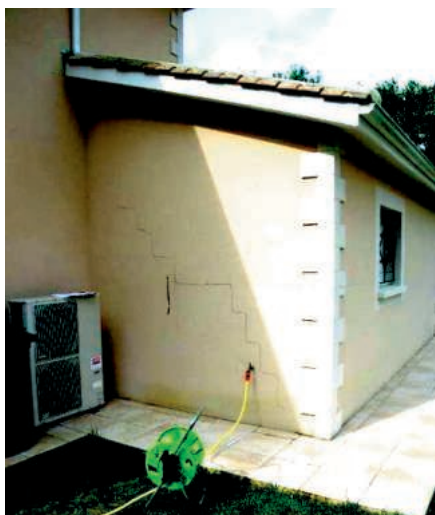
Figure 1 Exemple de cheminement de fissure en escalier (Source Socabat)
