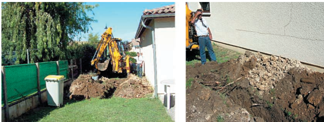
Figure 5 Exemple de pathologie (fissures) liées à la présence de racines sous la construction (vue d'ensemble à gauche et vue des racines et des fissures à droite) (Source Socabat)
