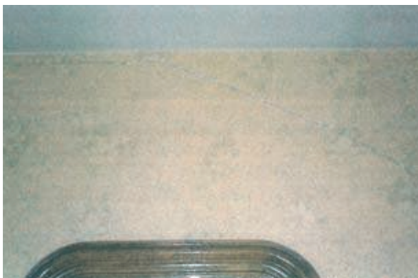
Fissuration intérieure, tapisserie déchirée - Maison André.
