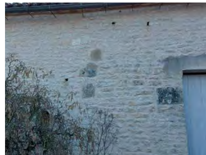
Trous dans les murs en moellons (source : Cittànova)
