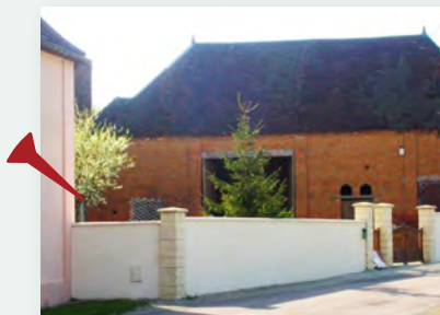
Clôture de parpaing enduit et poteaux de pierre artificielle sont inappropriés à l'architecture de cette belle grange de brique
