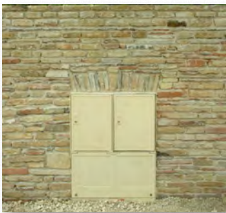
Coffrets parfaitement intégrés dans une maçonnerie de brique incluant un détail soigné (arc de décharge)
