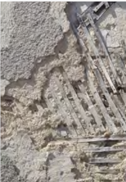
Enduit dégradé, les trois couches sur lattis sont visibles
