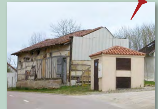
Combinaison des interventions au lieu de juxtaposer : un transformateur EDF à installer, et une grange en pan de bois à restaurer, l'occasion d'un projet unique de mise en valeur du bâti
