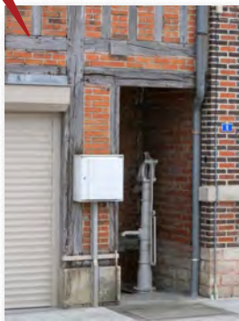
Coffret électrique installé sans souci du bâti (comme le volet roulant !)
