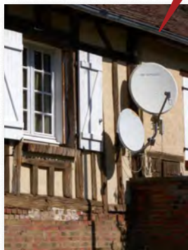
L'installation d'antennes paraboliques en façade nuit au caractère architectural du bâti
