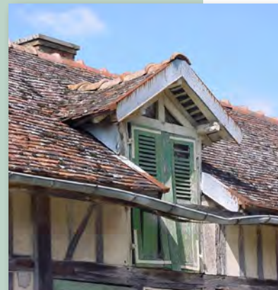
Lucarne passante avec une gouttière qui, n'ayant pas été interrompue, fléchit, Mesnil-Sellières
