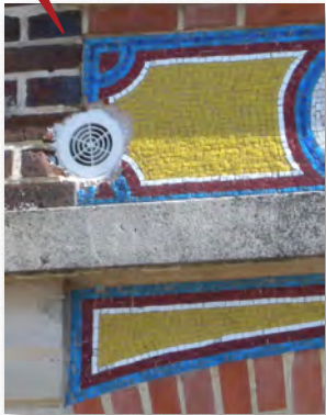
Grille de ventilation PVC détruisant une mosaïque de pâte de verre du XIX ème siècle
