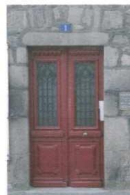
Le mur aurait dû être enduit autour du cadre de la porte
