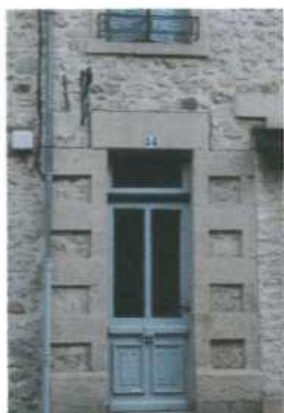
Cet encadrement de porte ne convient pas au mur de pierres apparentes
