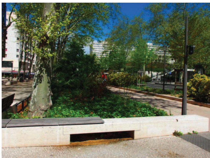
Bassin de stockage des eaux pluviales enterré sous la rue Garibladi, Lyon (69) © Sauvons l'eau
