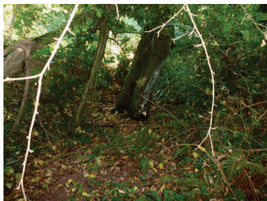
Photo 56 : Emplacement du fontis du Puits P7
