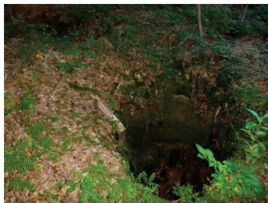
Photo 46 : Fontis Puits N°2 du Haut-Fiché
