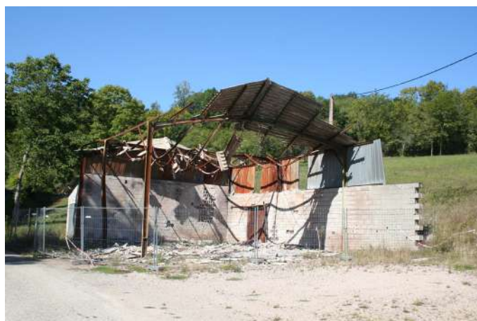
Photographie d'un bâti dégradé
