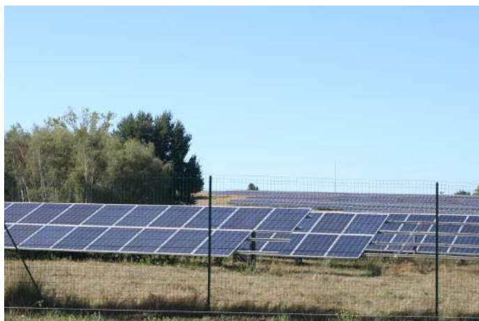
Parc de panneaux photovoltaïques, Daumazan-sur-Arize
