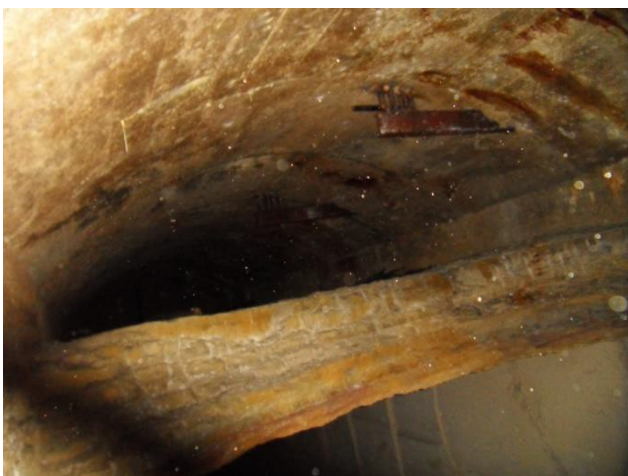
Illustration 16: Fontis avec voûte maçonnée en place. Galerie des V2. Source : rapport BRGM 2016
