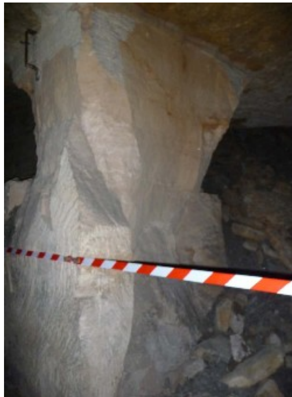
Illustration 13: Pilier fracturé en forme de diabolo au bord de l'effondrement des Auvions. Source : rapport BRGM 2016
