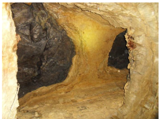
Illustration 15: Fontis dédoublé remonté jusqu'aux marnes Hauteriviennes (en foncé). Source : rapport BRGM 2016
