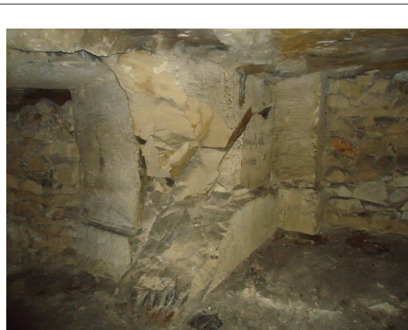
Illustration 6: Exemple de pilier de la carrière affecté par une fracture Source : rapport BRGM 2016
