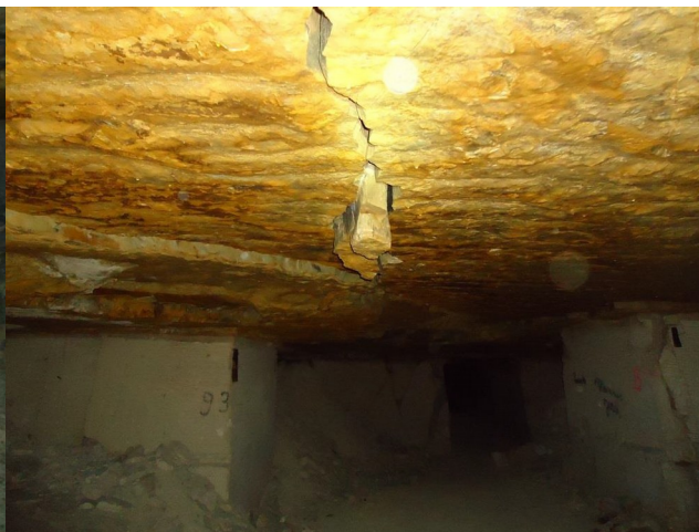
Illustration 20: Exemple de fracturation du toit de galerie. Source : rapport BRGM 2016
