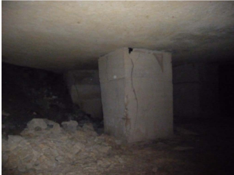
Illustration 12: Pilier fracturé dans le secteur des Auvions. Source : BRGM 2011
