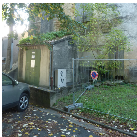
Fig. 5. Traitement des équipements techniques sur l'espace public
