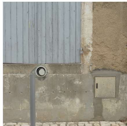
Intégration des équipements techniques sur la façade ( coffres, ventouses...)
