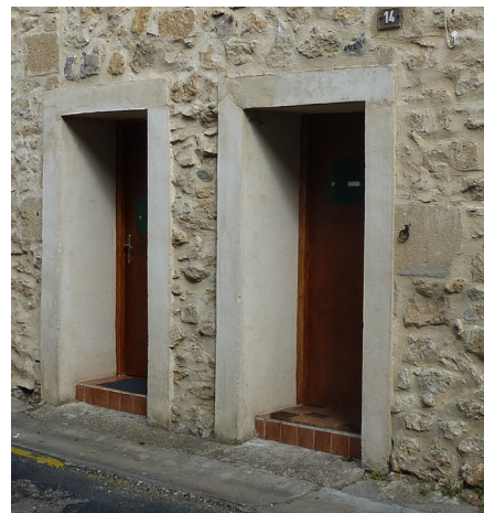
Encadrements en ciment et «décroûtage» de la façade.
