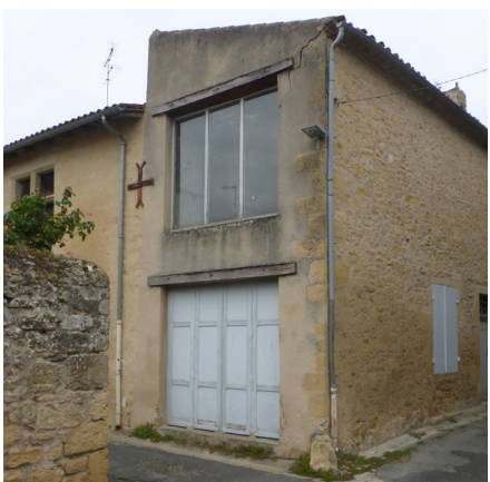
Transformation de l'ancien, non respect des éléments régulateurs de la composition de la façade.
