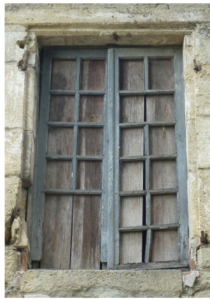
Partition du vitrage à petits carreaux type XVIII e siècle, fin XIX e -déb. XX e feuillure dans l'encadrement de la baie pour recevoir le contrevent fermé.
