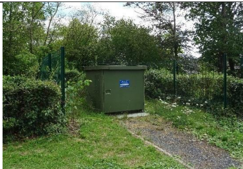
Armoire électrique dans une teinte verte et entourée d'une haie (Willies)
