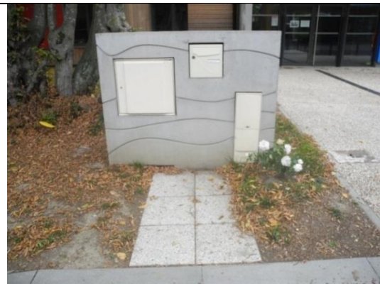
Coffrets et boîte aux lettres regroupés et intégrés dans un muret près de l'entrée d'un équipement (Eclabes)
