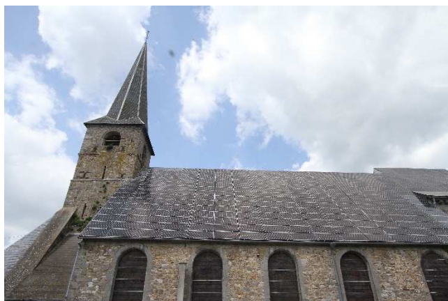
Installation de panneaux photovoltaïques réalisée dans le respect de l'existant, Dompierre. Source : PNR de l'Avesnois
