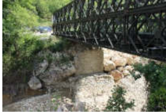
Ouvrage LAN02 – Déruil lors de l'événement du 13/09/2015
