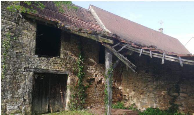
Etat de friche à Rampoux
