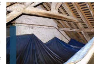
Bâches de protection dans un comble
