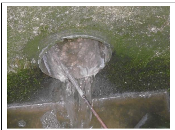
Sortie du premier étage du bi-filtre
