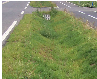
Noue enherbée et évacuation par ouvrage en béton à Balma (31)
