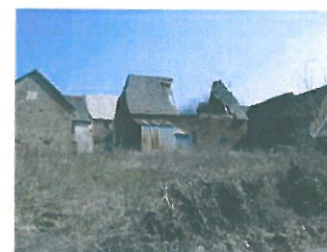
Un patrimoine bâti dégradé
