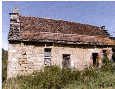
Sabazot, p18 : cette maison conserve un égout et des rives en lauses semblant attester de la présence à l'origine d'une couverture en chaume.
