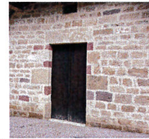
décroûtage des façades et joints clairs
