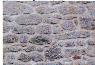
Joints en creux et Ton / ton gris (non)
