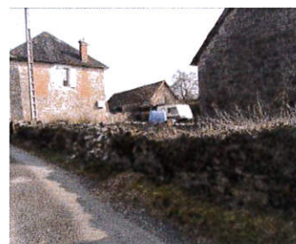
Mur effondré à la Martinie
