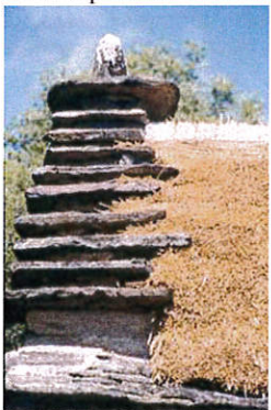
Exemple de couverture en chaume arrêtée en rives par un pignon en lauses (photo ass. Cézallié).
