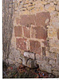
Laffont, p106 : présence d'un évier signalé par un écoulement surmonté d'un fond en gré rouge.
