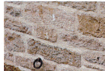
Joints trop minces et Ton / ton beige (non),
