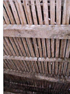
Plancher à claire-voie
