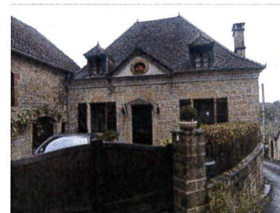
Rosier p. 9 : on peut supposer que cette façade était jadis recouverte d'un enduit à la chaux comme semble l'attester le fronton.
