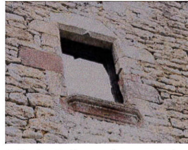
Creffond p 41 : l'amorce du meneau et les mortaises orphelines des croisillons évoquent l'ancienne division de pierre.
