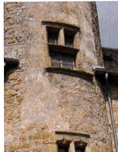
Château du Peuch : vestige d'un enduit fin badigeonné sur la tour d'escalier
