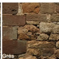
Grès Appareillage en terre Saint-Cernin-de-Larche
