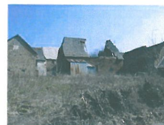
Un patrimoine bâti dégradé
