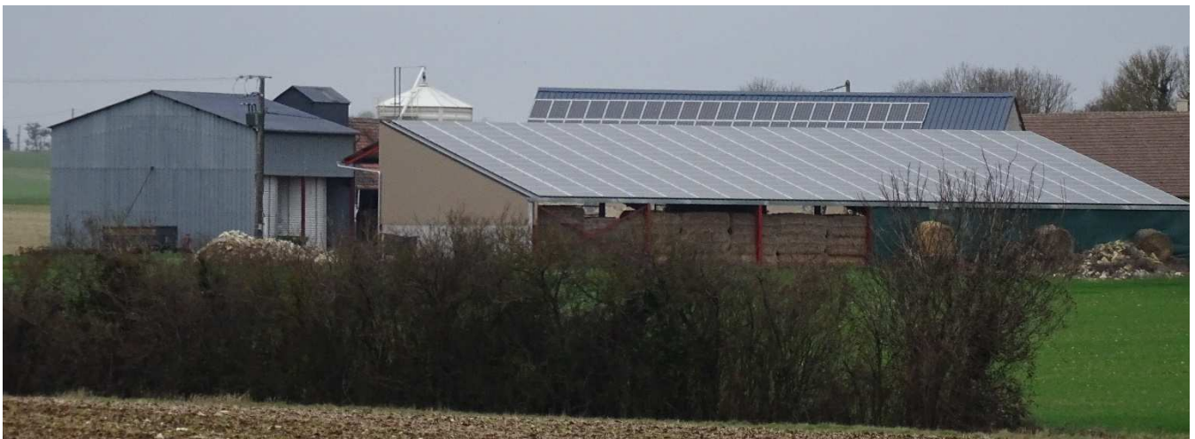
Photo : Panneaux solaires sur la toiture d'une exploitation agricole à Bengy-sur-Craon, près de l'étang du Grenouillon (source : Biotope, février 2017).
