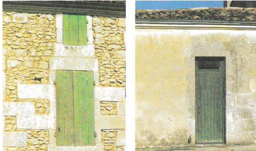
Ces moellons doivent être recouverts d'enduit.
