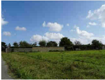
Mur en parpaing non enduit donnant un aspect négligé à l'interface
