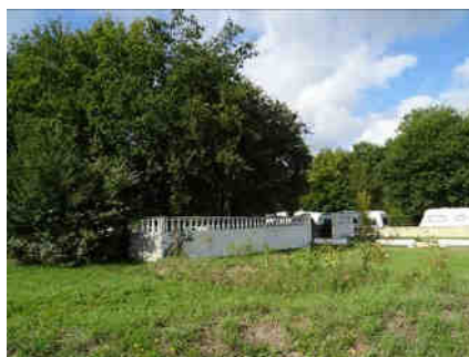
Clôtures dégradées et hétérogènes - Chemin du Grand Vessac
