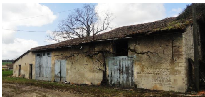
Exemple d'ancien corps de ferme vacant et très vétuste dans le bourg de Tugeras
