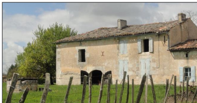
Ancienne petite ferme relativement ancienne munie d'ouvertures cintrées. Un bâti vacant et dégradé à préserver et à réhabiliter située dans le bourg de Tugéras.
