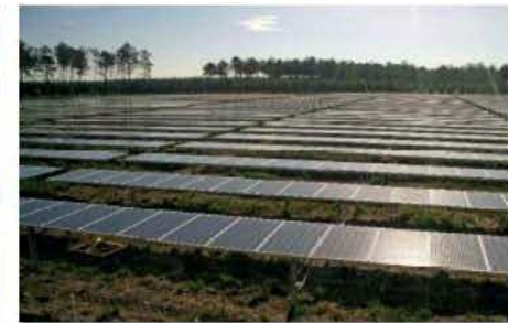
Parc Solaire avec Trackers – 12.0 MWc Sainte Hélène (33) Foncier Communal → Développement, Financement, Construction et Exploitation
