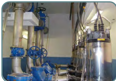
Postes de refoulement du « Rhâ » à Saint-Palais-sur-Mer.
