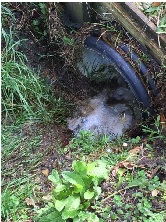
Figure 8 : vue de la présence d'eaux grises dans le fossé en amont de la partie canalisée du réseau de Chez Mouchet
