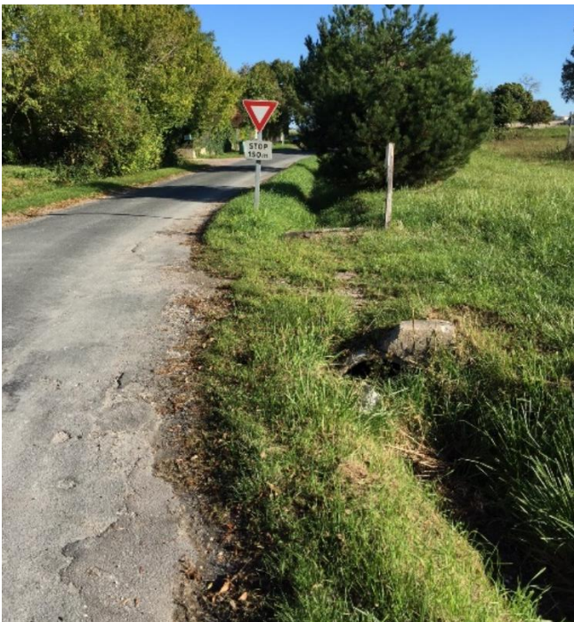
Figure 9 : vue d'un busage à nettoyer
