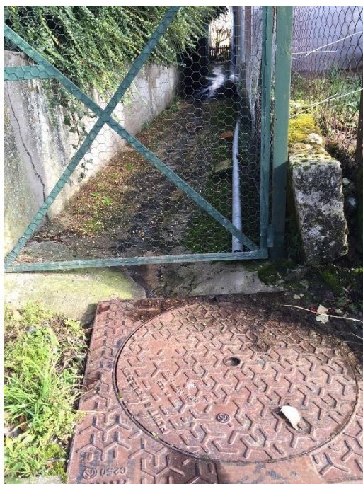
Figure 13 : vue du regard où des rejets non conformes ont été repérés
